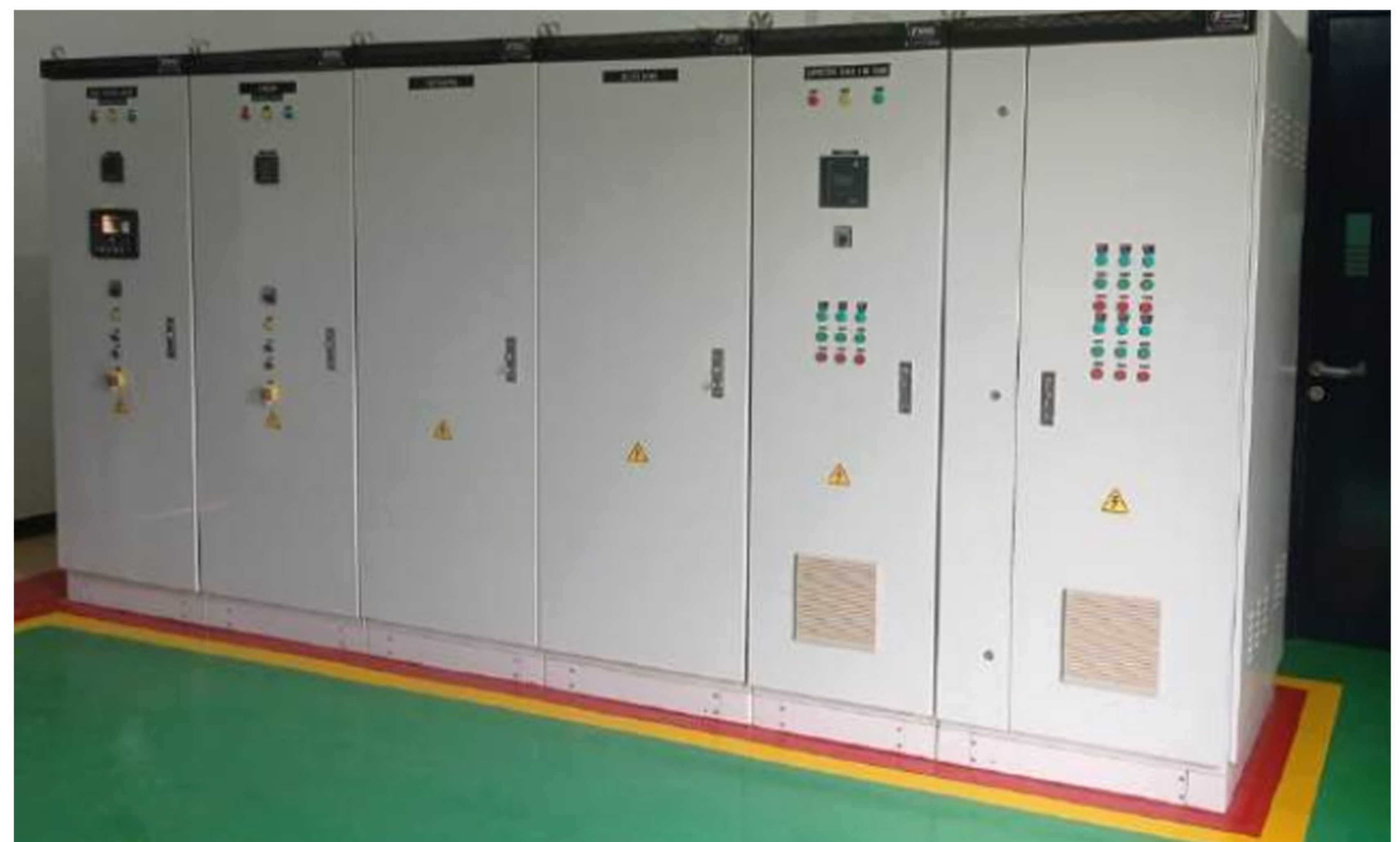
Panel LVMDP – ATS & AMF Project IKN – Jalan Sumbu Kebangsaan Sisi Timur – IKN Kalimantan Timur
